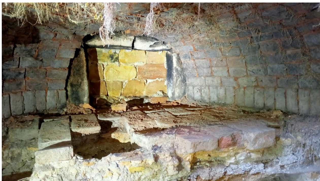
La voûte et la gueule du four
