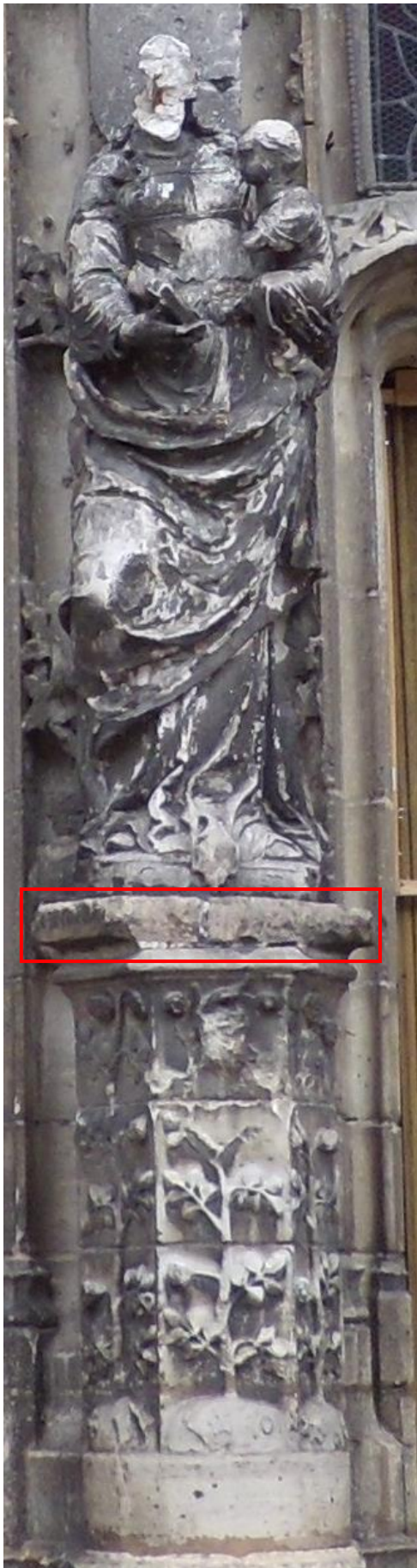
Le trumeau de la façade occidentale de l'église avant les travaux de 2019, avec le socle portant l'inscription gravée.
