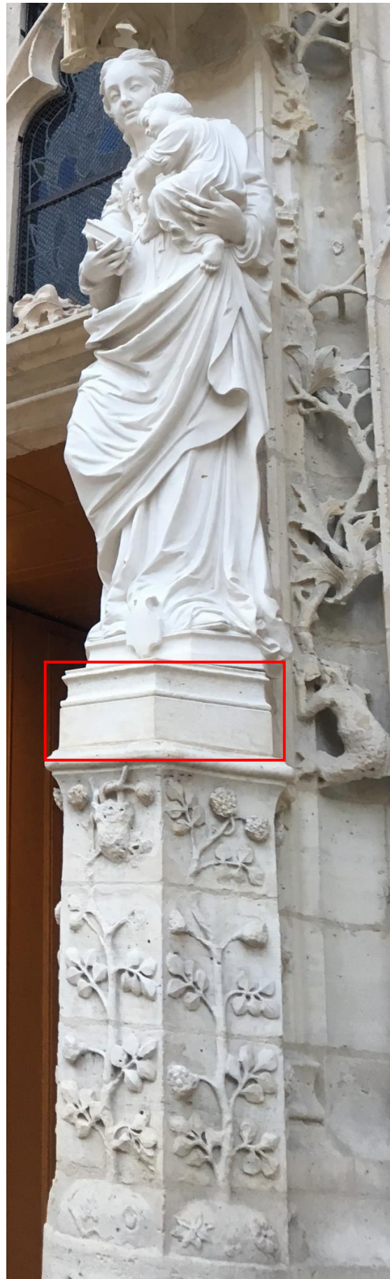
Le trumeau de la façade occidentale de l'église après les travaux de 2019, avec un nouveau socle de substitution.
